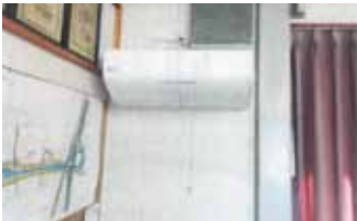
1-3 東三クラブ空調設備
